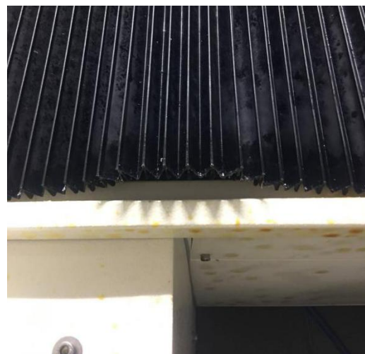
皮老虎运行轨道错位
